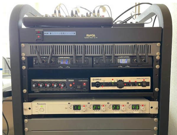
音響システムラック
